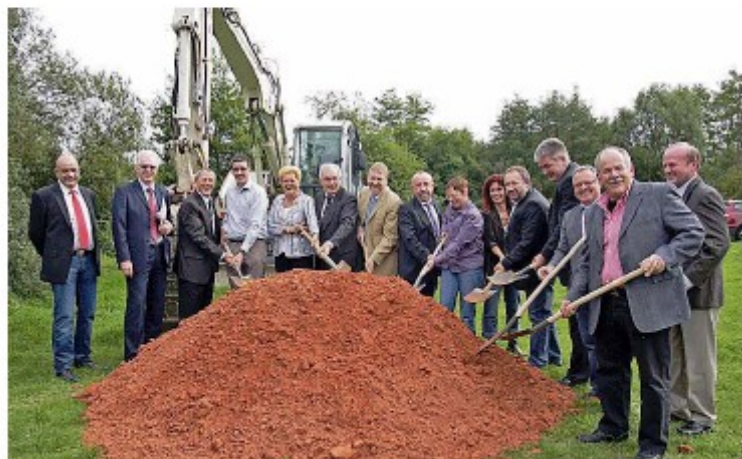
Landrätin Monika Bachmann (Fünfte von links) versammelte Bürgermeister und Tierschützer zum Spatenstich. Foto: Heike Theobald
